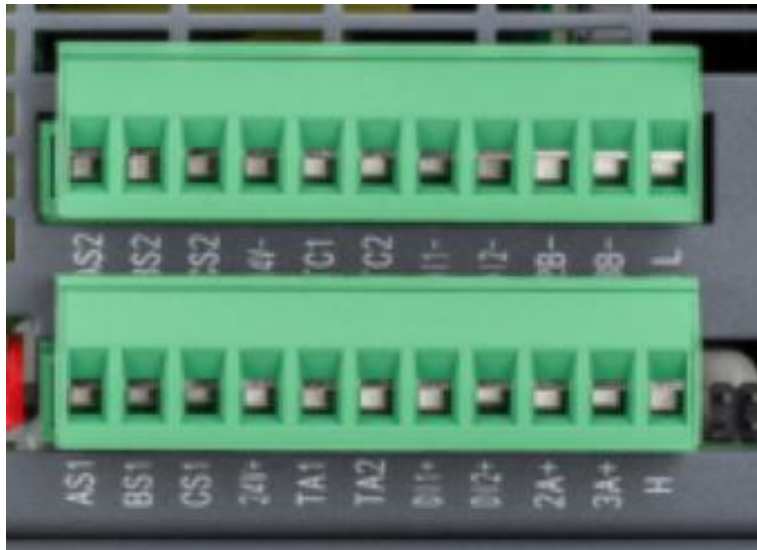
Rys. A — fizyczny widok listwy wejść/wyjść: przekładniki (AS/BS/CS), zasilanie 24V, styki alarmowe TA/TC, wejścia DI, komunikacja RS485/CAN.
